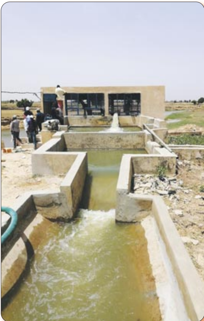
Station de pompage, aménagement CDA Diffa
